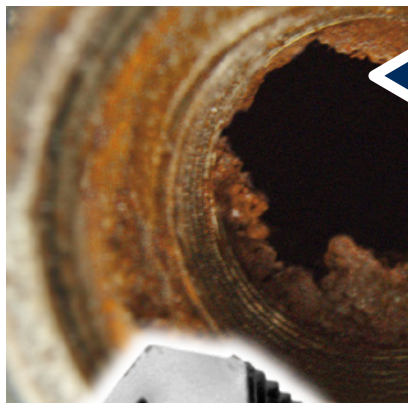
I mere alvorlige tilfælde af korrosion kan metalkomponenter og rør gå i stykker
