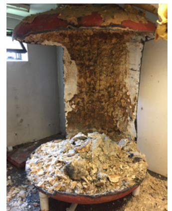
Den gamle varmtvandsbeholder i Kagsgården var kalket fuldstændig til indvendig. Det sker ikke med det nye anlæg, hvor der er tilkoblet et blødgøringsanlæg.
